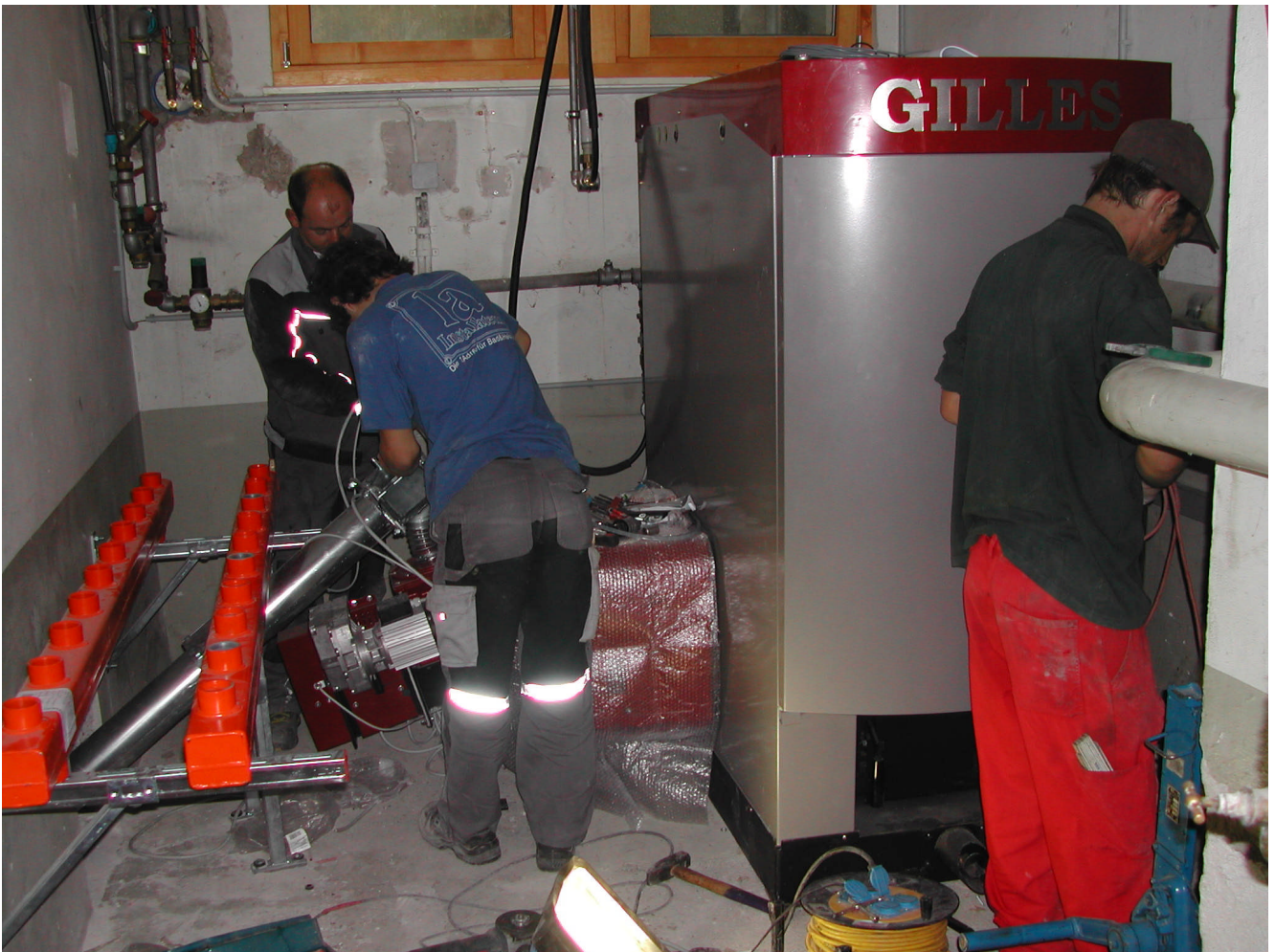
Heizanlage im Gemeindezentrum
