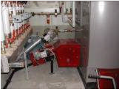
Verteiler- Messanlage Pelletsheizung
