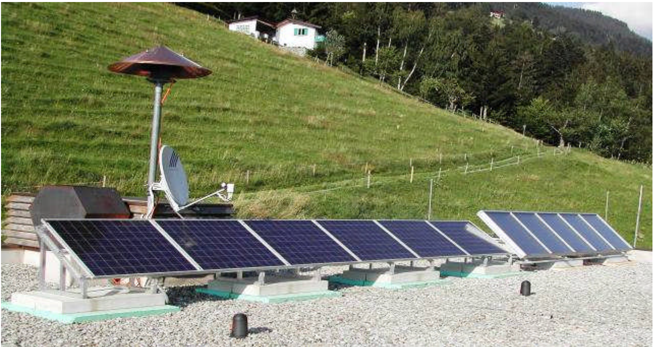
PV- Anlage und thermische Solaranlage auf dem Dach des neuen Gemeindezentrums
