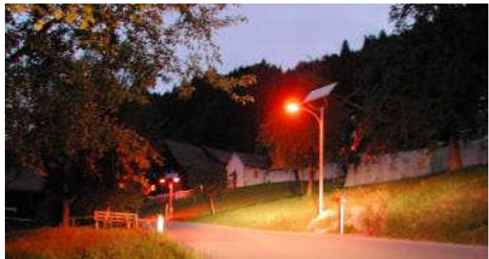
Solarlampe Ortsteil Bassig
